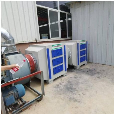
刷漆房二级活性炭吸附装置
