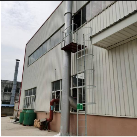
烘干炉排气筒 DA001
